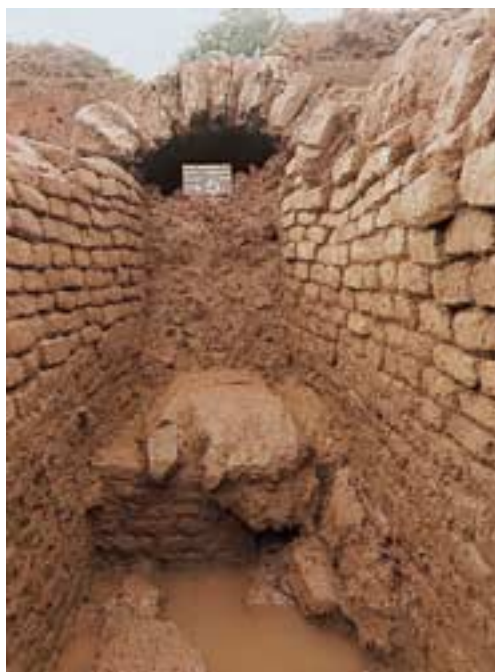
Abb. 18: Blick in das Tosbecken von Mechernich-Lessenich ge- gen die Fließrichtung des Wassers. Die Stufe am Be- ginn des Beckens ist stark übersintert.
