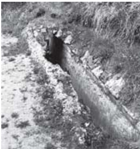
Abb. 40: Teilweise zerstörte Eifelwasserleitung bei Kall-Urft links des Weges zum Haus Neuwerk.
