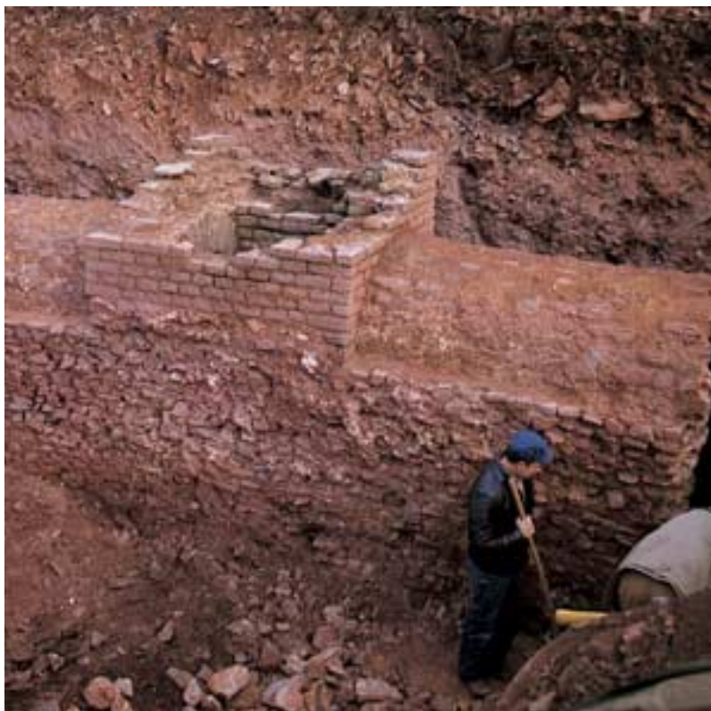
Abb. 24: Typischer Einstiegschacht in die Eifelleitung zum Zwecke der Kontrolle und Wartung; hier ein Schacht bei Mechernich-Breitenbenden.
