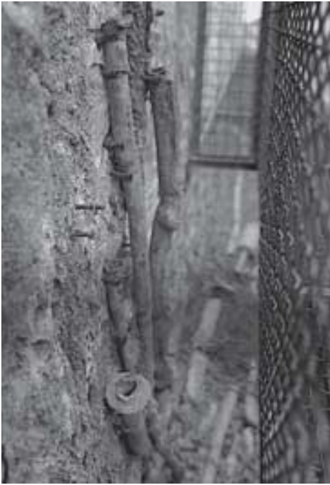
Abb. 109: An einer Hauswand verlegte Steigrohre einer Wasserversorgung in Pompeji (Italien).
